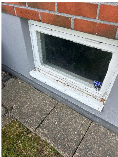
Underhåll/målningsbehov av källarfönster.
