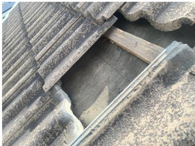
Tak, äldre/original, underlagspappen torr med blåsor.
