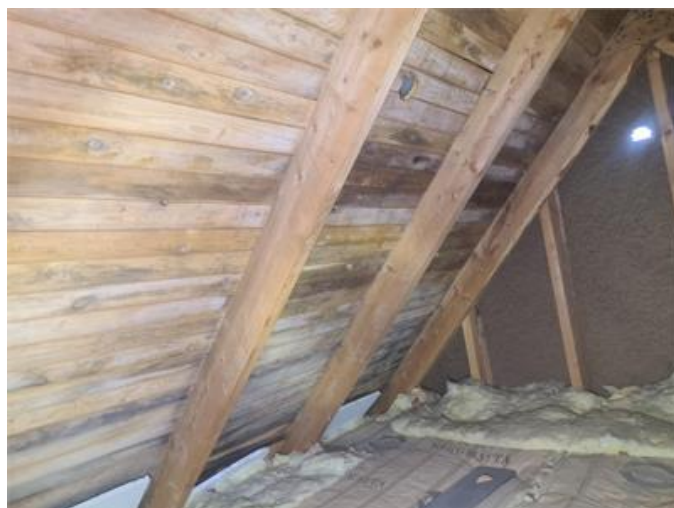
Nockvind, mikrobiell påväxt i underlagstaket sk konvektionskada.
