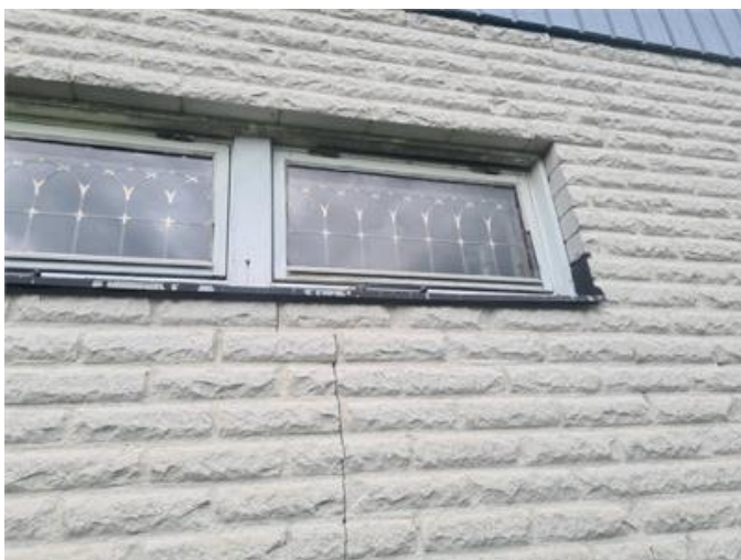
Fasad Tegel, spricka vid södra gaveln.
