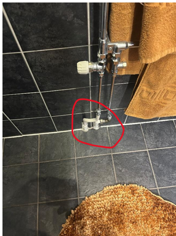
Rör genomföringar i golvet avviker från dagens branschregler.
