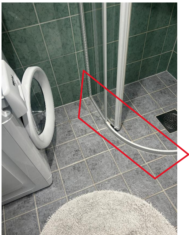
Om vatten skulle läcka ut från tex tvättmaskinen kan vattnet inte ta sig till golvbrunnen.
